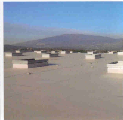
Magazzino logistica, Anagni (FR). Copertura con membrana sintetica fissata meccanicamente su solaio in lamiera.
